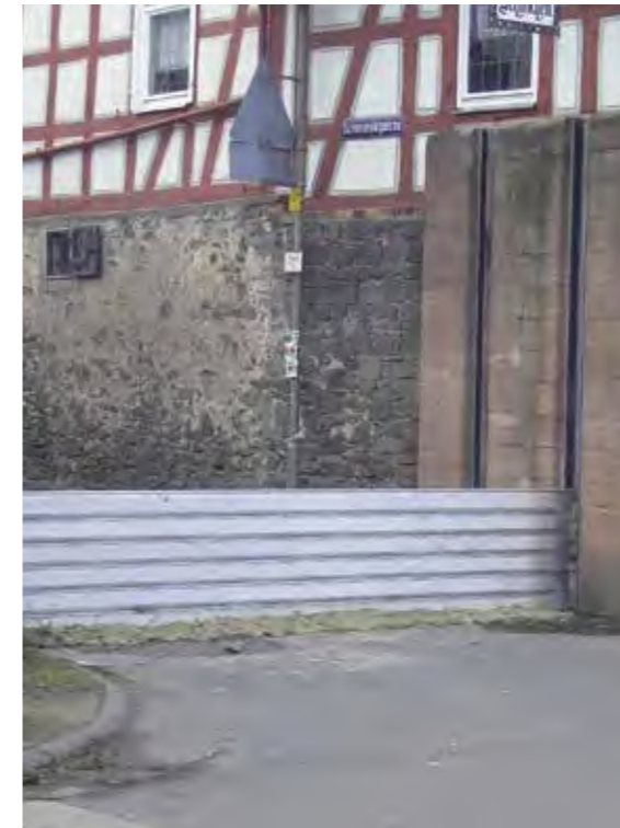
Mobile Hochwasserschutzanlage in Rumpenheim.
