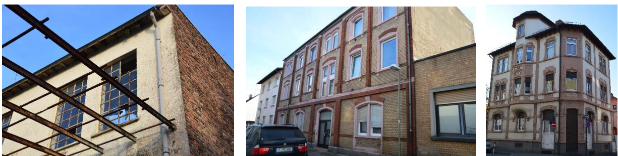
Abbildung 115: Gebäude mit Sanierungsbedarf, Gebäude mit leichten Mängeln und erhaltenswerte historische Fassade in der gründerzeitlichen Erweiterung. Quelle: Stadt Offenbach, 2017.
